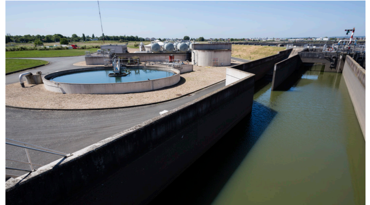
Système de traitement des eaux pluviales (STEP), Paris-Orly.
