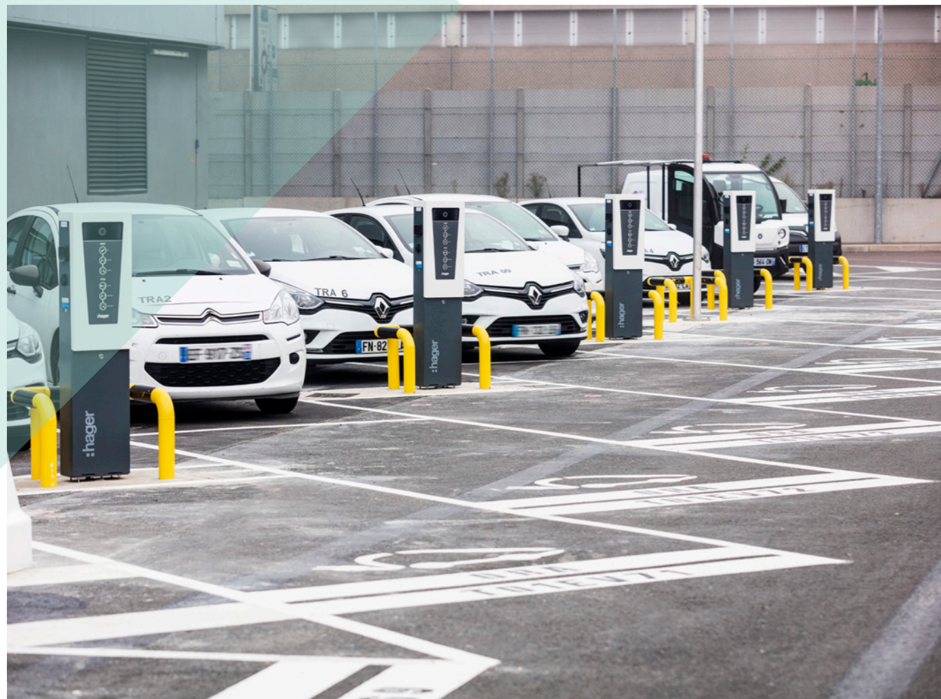
Bornes de recharge de véhicules électriques.
