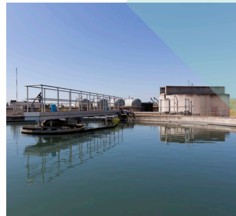
Système de Traitement des Eaux Pluviales (STEP), Paris-Orly
