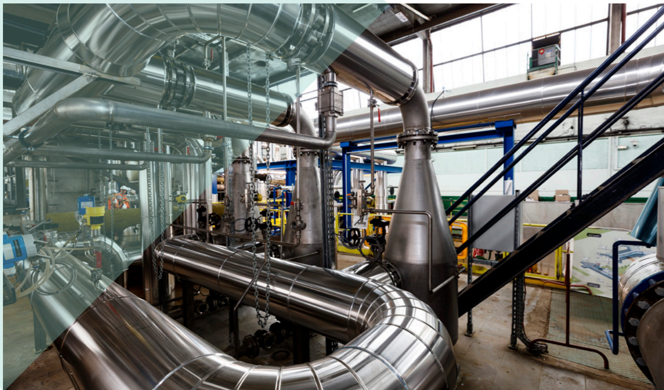
Filtration géothermique, centrale-thermo-frigo-électrique (CTFE), Paris-Orly.
