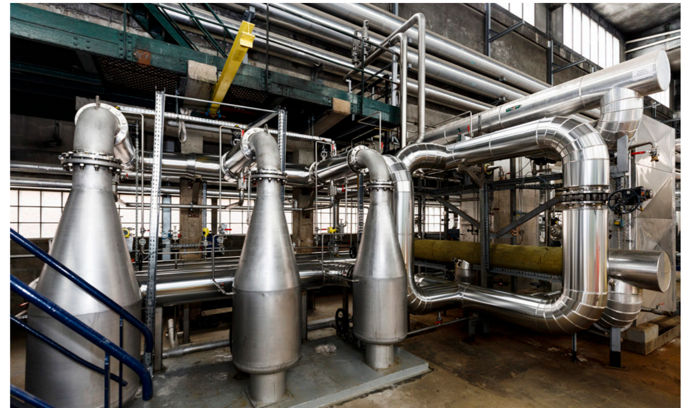
Filtres cycloniques géothermie, Centrale-thermo-frigo-électrique (CTFE), Paris-Orly.
